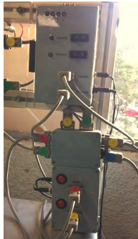
Figura 4 Drives actuales para el control de los motores a pasos.
